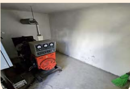
▲ 동춘당근린공원 라돈 저감장치 설치 전
