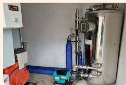
▲ 동춘당근린공원 라돈 저감장치 설치 후 모습
