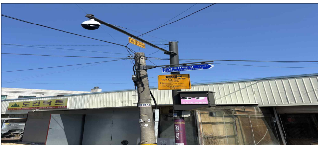
<방법용 CCTV 신규설치>
