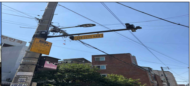
<방법용 CCTV 성능개선>
