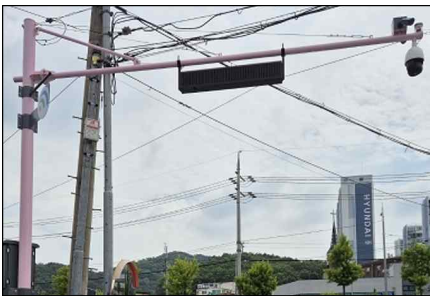
<방법용 CCTV 신규설치>
