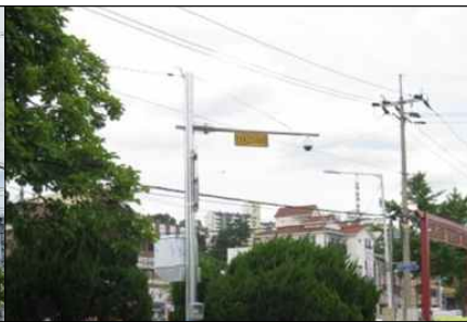
<방법용 CCTV 성능개선>
