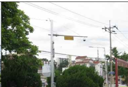
<방범용 CCTV 성능개선>
