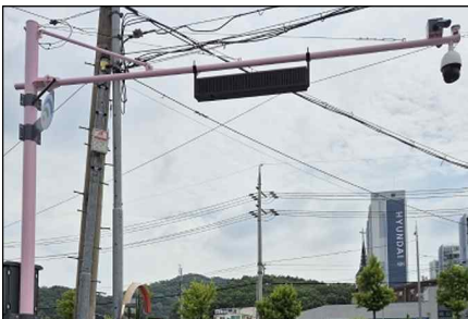
<방범용 CCTV 신규설치>
