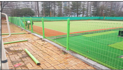
송촌생활체육공원 게이트볼장 펜스 개보수
