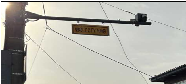
<방범용 CCTV 신규설치>
