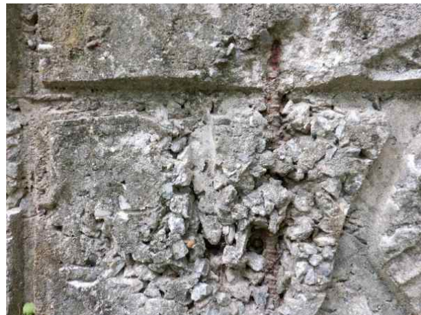
종점부 콘크리트 옹벽 철근노출
