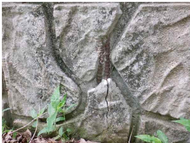
종점부 콘크리트 옹벽 철근노출 및 파손
